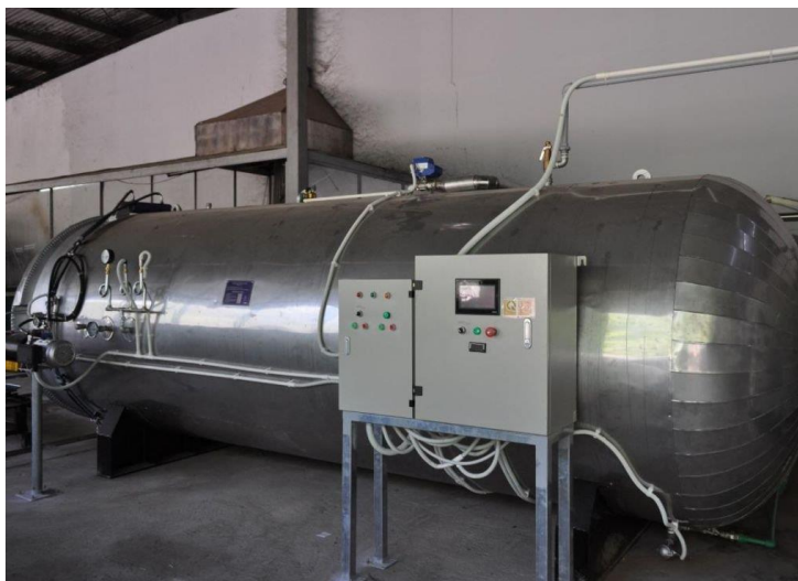
Nồi hấp xử lý rác bằng công nghệ nhiệt ướt của Viện nghiên cứu cơ khí, Bộ Công thương. Ảnh: NVCC.
