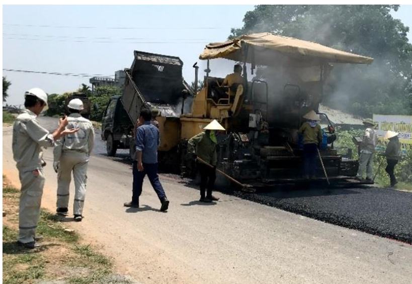
Thi công thử nghiệm mặt đường nhựa sử dụng sử dụng phụ gia là phế thải nhựa
