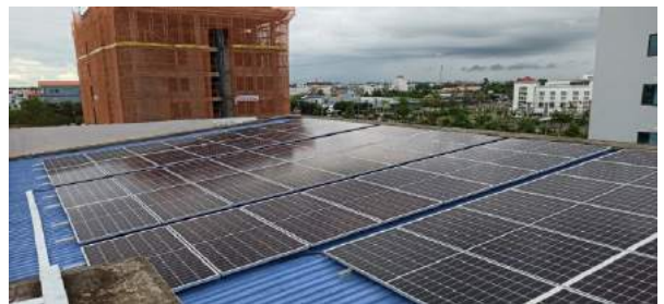
Dự án ứng dụng hệ thống điện mặt trời vào hoạt động của trụ sở Ban Quản lý dự án Đầu tư Xây dựng và Khu vực Phát triển Đô thị tỉnh An Giang
