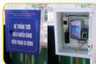
Hệ thống tưới tự động
