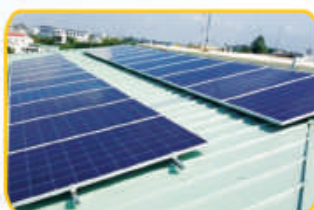
Hệ thống điện năng lượng mặt trời
