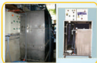
Hệ thống xử lý nước thải
